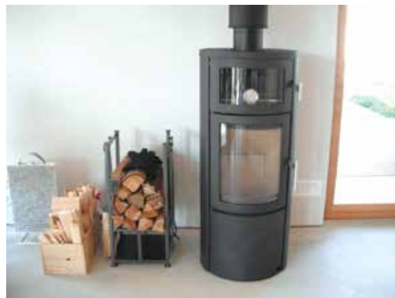
温浴施設に導入された薪ストーブ (各務原市)
