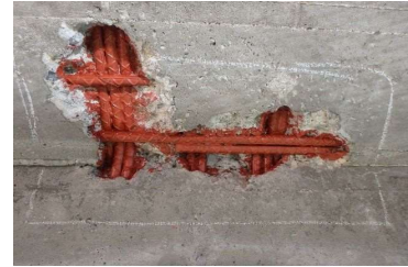
床版の鉄筋露出
