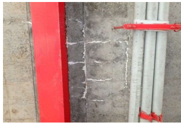
床版のひびわれ、遊離石灰
