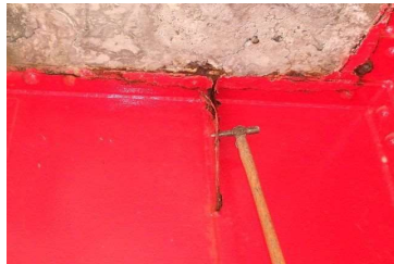
横桁の腐食(孔開き)、防食機能の劣化
