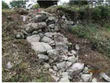
崩落石の堆積状況
