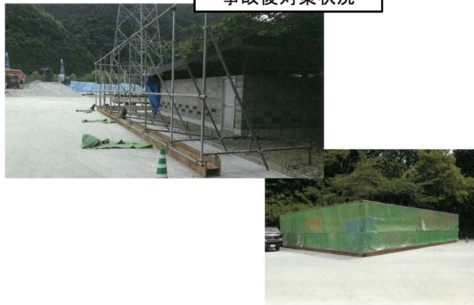
事故後対策状況
