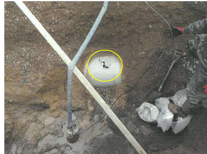
管の破損状況写真
