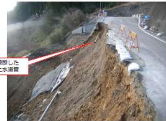
上水道破断状況
