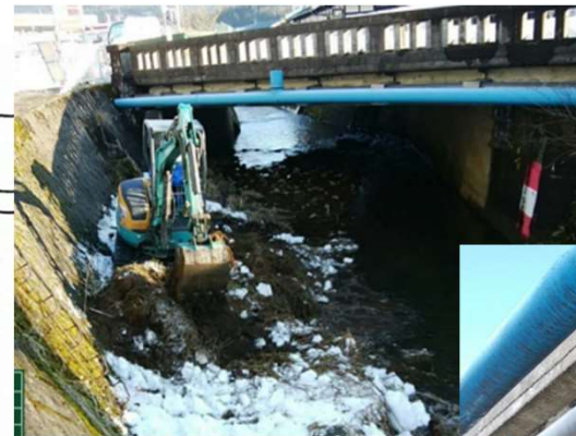
事故現場状況写真
