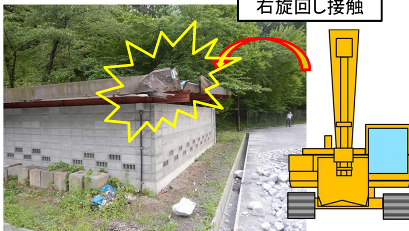
事故現場状況
