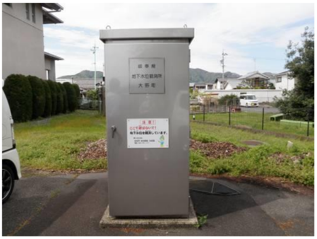
地下水位観測所の例
