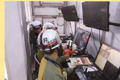
無線重機操作室
