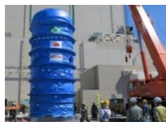
ⓑフィルタバント設備（設置前）
