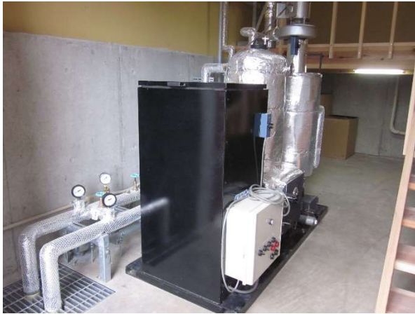
木質資源ボイラー
