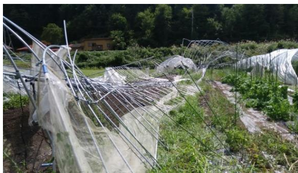
風水害によるパイプハウスの倒壊
