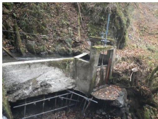
老朽化した用水施設
