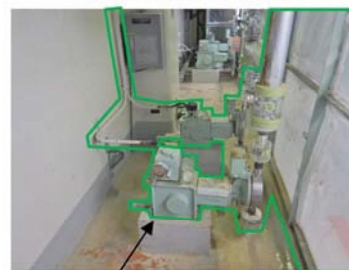
硫酸注入ポンプ、配管類、仕切り板、電気計装品類
