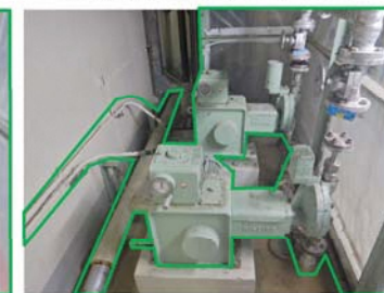
苛性ソーダ注入ポンプ、配管類、仕切り板、電気計装品類
