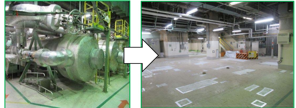
【補機冷却水熱交換器】
