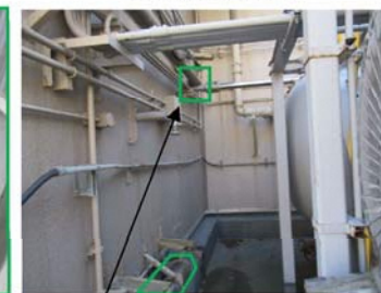
配管類、電気計装品類
