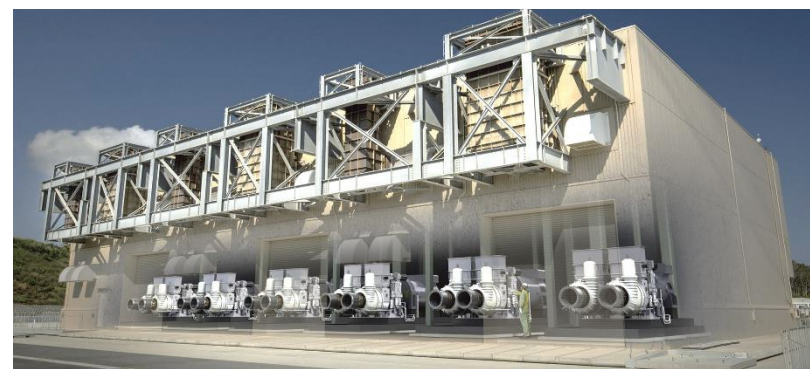
緊急時ガスタービン発電機
