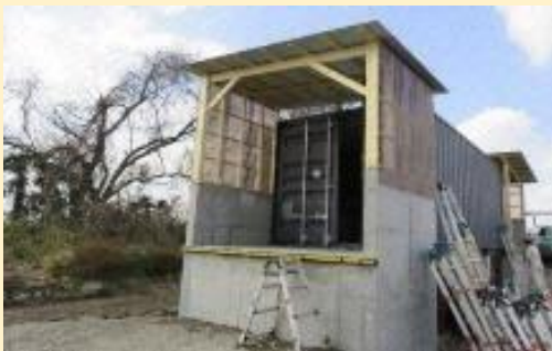
コンテナを活用した出荷デポ
