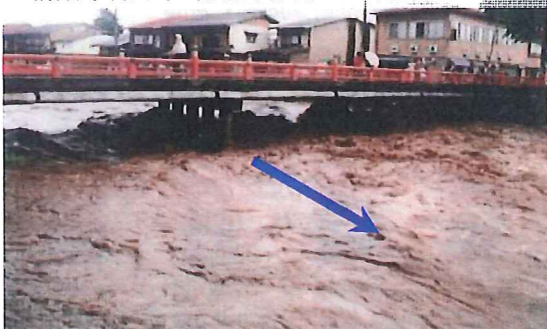
平成11年6月30日 集中豪雨による出水 (飛騨市古川町 荒城川最下流「今宮橋」)
