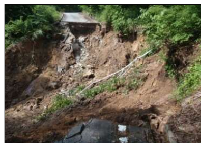
林道被害（飛騨市）
