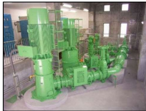
実施後（揚水機場内ポンプ）
