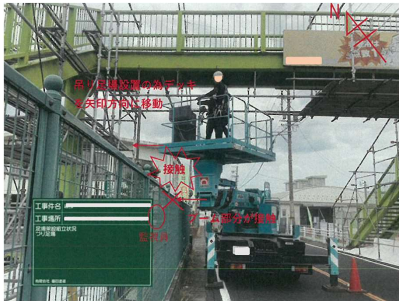
事故現場状況写真1
