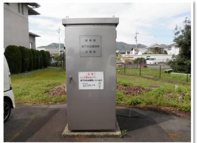
地下水位観測所の例
