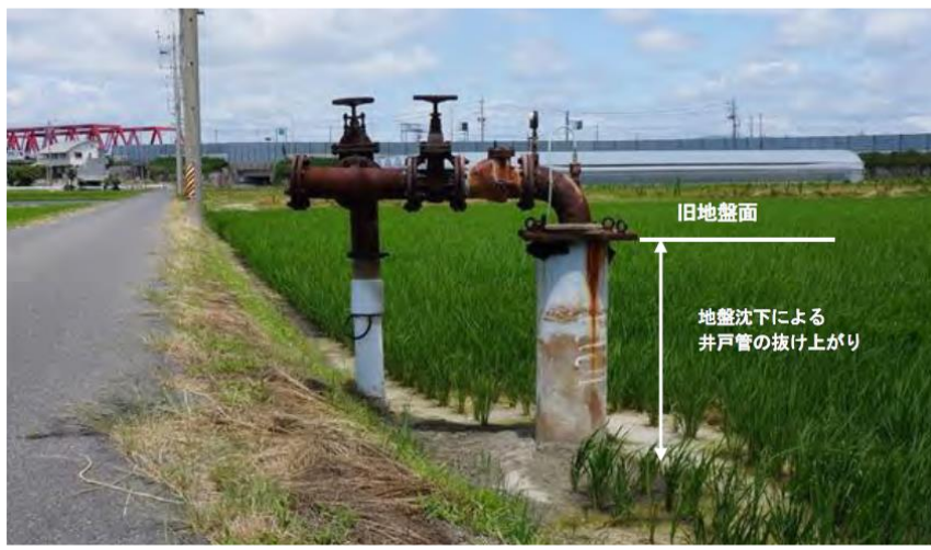
井戸の抜け上がり(三重県木曾岬町 H26.6月) 東海三県地盤沈下調査会より
