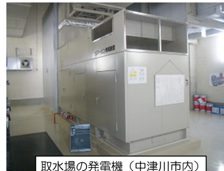
取水場の発電機（中津川市内）
