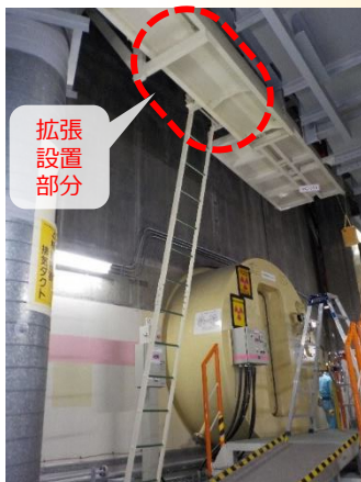
改善要望の聴取りを踏まえた設備対策例 梯子昇降に伴う墜落防止のため、梯子を固定できる架台を拡張設置
