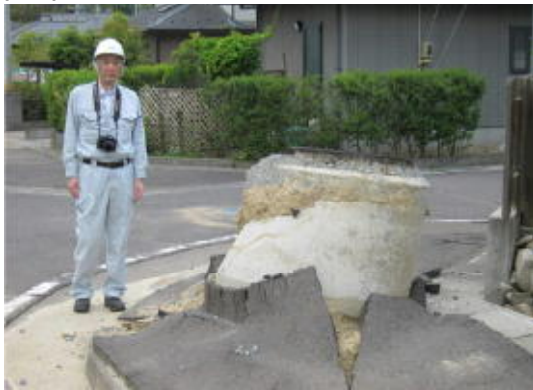
地盤液状化によるマンホールの浮き上がり (宮城県白石市緑が丘付近)
