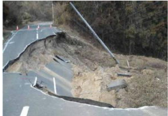
宮城県大崎市内(震度6弱)県道の被災状況 (道路盛土が崩壊し通行止め)
