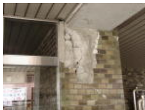
柱頭の損傷状況
