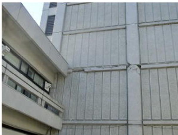
【東北大学 校舎 柱被害】
