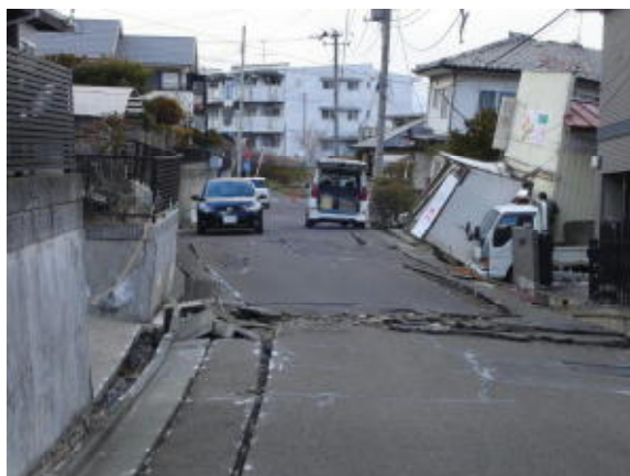
地滑りにより、道路に亀裂が生じ道路右側の宅地が沈下している。
