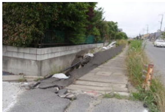
地盤液状化による埋設パイプラインの浮き上がり (茨城県潮来市日の出)
