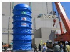
ⓓフィルタバント設備（設置前）
