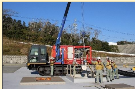
可搬型注水設備操作訓練
