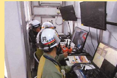
無線重機操作室
