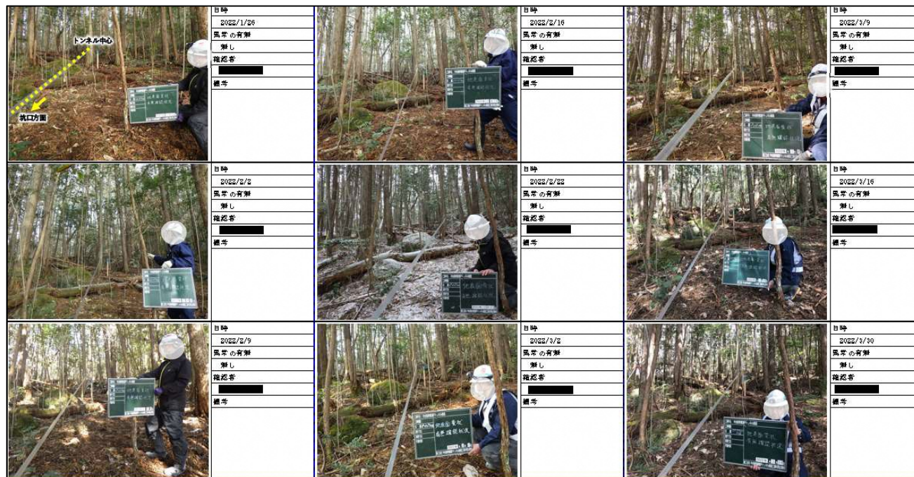
肌落ち発生箇所の地表面における沈下確認状況写真
