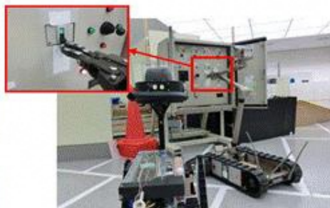
制御盤を開放しスイッチ操作
