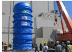
ⓓフィルタバント設備（設置前）
