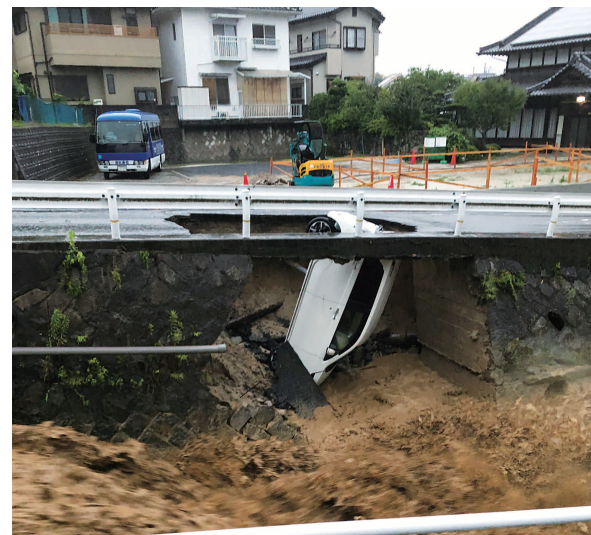
道路陥没により転落した車 平成30年7月豪雨災害(広島県海田町) 提供:広島県海田町
