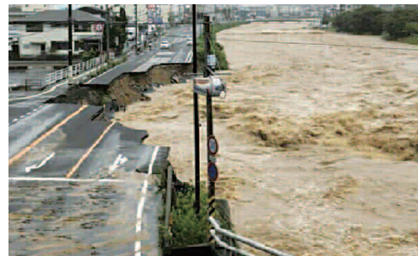
洪水による道路崩壊 平成30年7月豪雨災害(広島県広島市) 写真提供:国土交通省中国地方整備局
