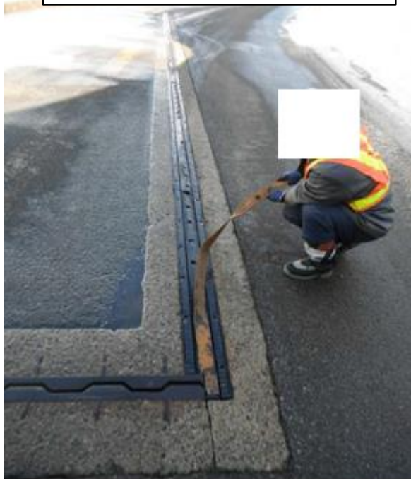
剥がれた鉄板の状況
