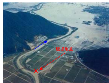
岐阜市石谷 破堤地点
