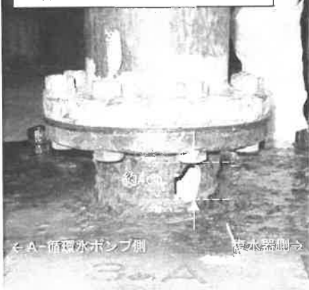
漏えい箇所(貫通孔)写真
