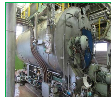
【補助ボイラー】
