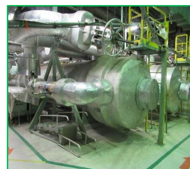
【補機冷却水熱交換器】
