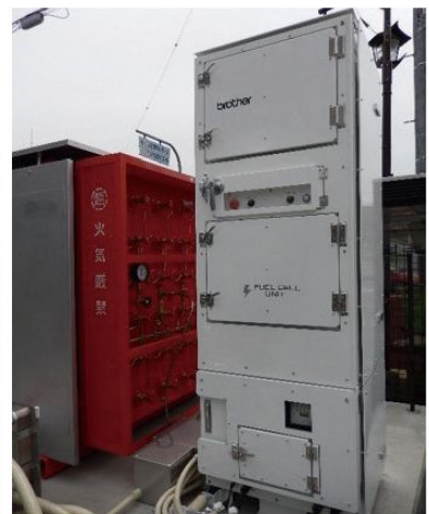
燃料電池ユニット
