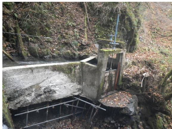
老朽化した用水施設
