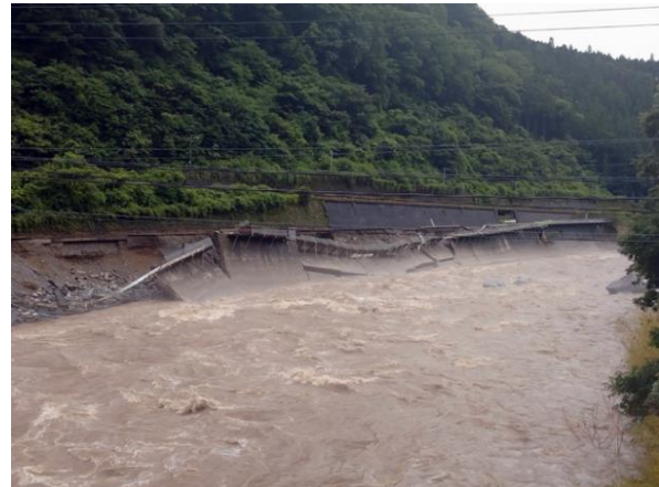
図 6-15 令和 2 年 7 月豪雨災害 (下呂市小坂町門坂地内 国道 41 号道路崩壊状況)
