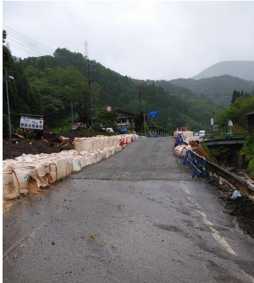
仮設道路設置完了 片側交互通行にて通行再開しました。 (令和2年7月17日)
