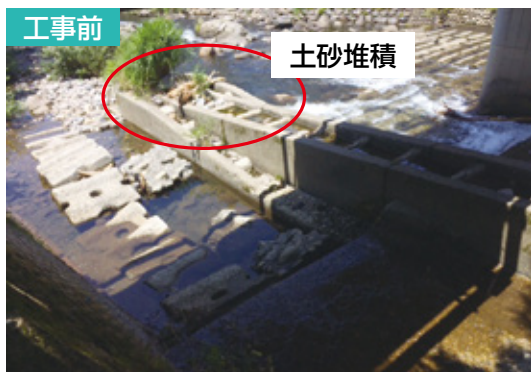
魚道内に土砂が堆積
