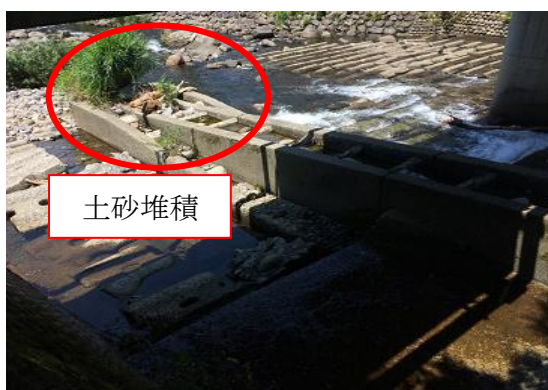
工事前 魚道内に土砂が堆積 【前川(郡上市)】
