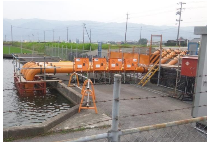
写真 2.2 専用ポンプ施設
