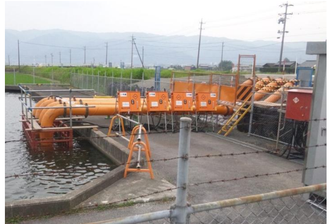
写真-2 専用ポンプ施設
