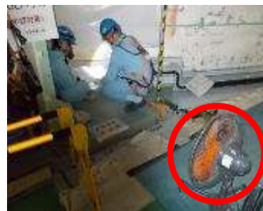
【換気を行うためのファン設置】
