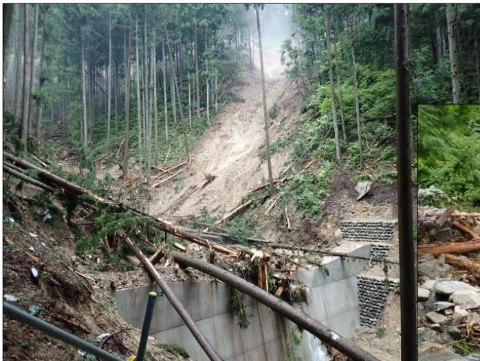
崩壊地の直下で谷止工が崩土を捕捉 →土砂の流下エネルギーの増大を抑止
