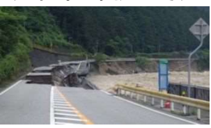
⑦道路崩壊 (下呂市・国道41号)
