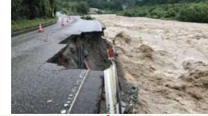
①路側崩壊 (高山市・国道471号)
