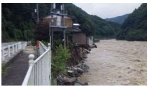
⑤護岸崩壊 (下呂市・飛騨川)
