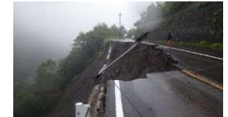
③路側崩壊 (高山市・乗鞍公園線)
