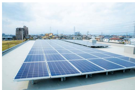
■ 太陽光パネル
