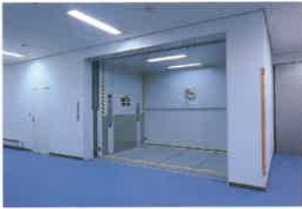
搬入用エレベーター
