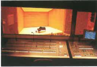
ホール音響照明設備
