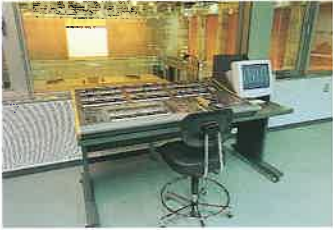
ホール音響照明設備
