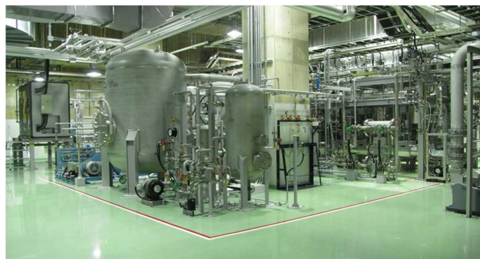
排気ガス処理システム
