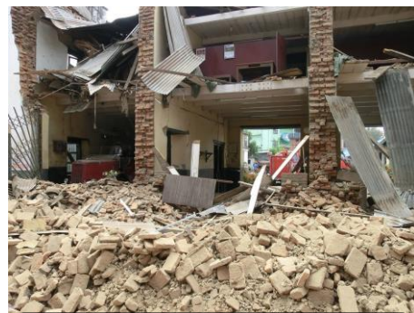
撮影地：ラリトプール群プルチョーク 2015年の地震で半壊した消防署
