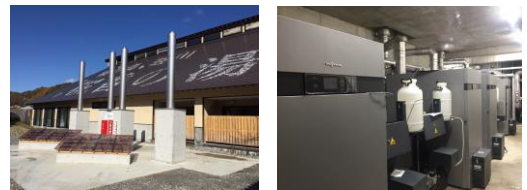
<温泉施設ボイラー(高山市)>
