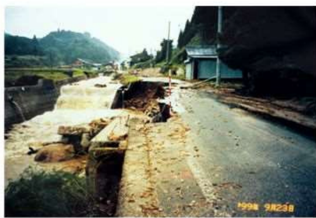
9. 15豪雨(平成11年度) 稲越川被災状況 (飛騨市河合町稲越地内)
