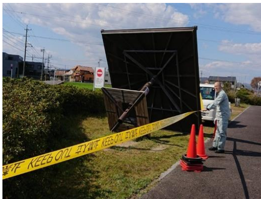
当該施設の倒壊状況と事故後の措置状況
