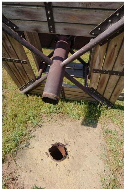
四阿の支柱の破断状況
