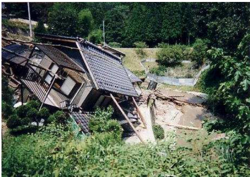
土砂による家屋全壊現場：恵那市上矢作町飯田洞地区 (岐阜県総合防災ポータル)
