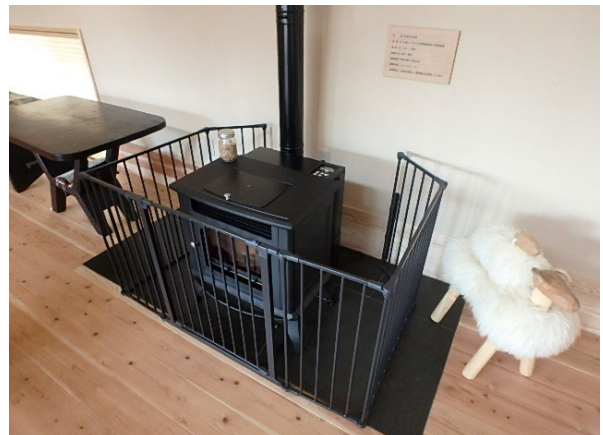
ホテルの食堂内に導入されたペレットストーブ(関市)
