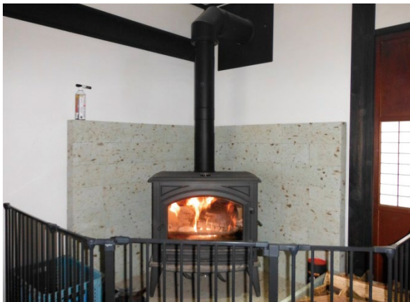
民宿施設内に導入された薪ストーブ(郡上市)
