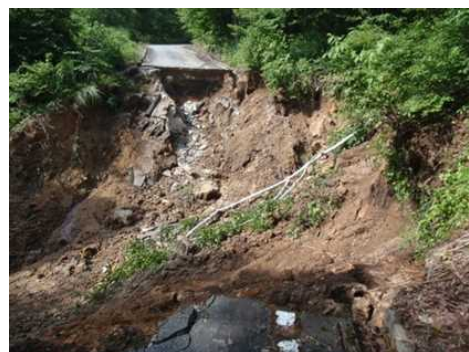
豪雨災害で被災した林道
