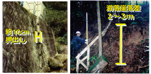
護岸の押し出し変状 大ブロックの頭部滑落崖
