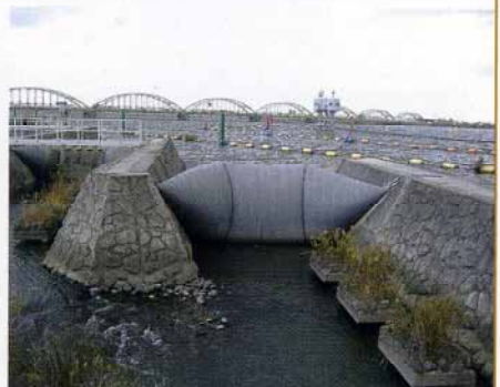
ゴム引布製起伏堰（せせらぎ魚道上流部）
